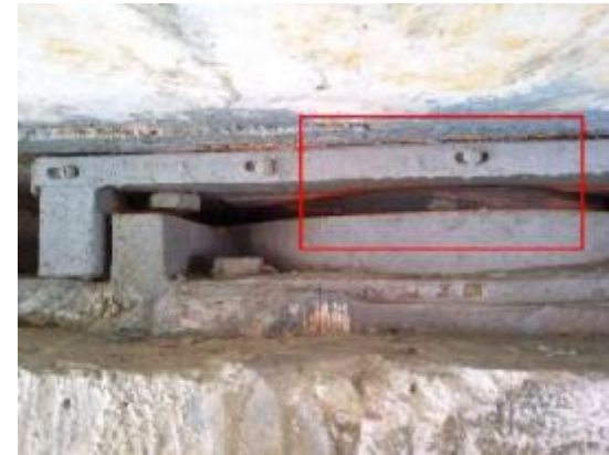
图 3-28: 西芹大桥（上行）ZZ-3-3-2 支座：盆式支座橡胶体裂纹。
