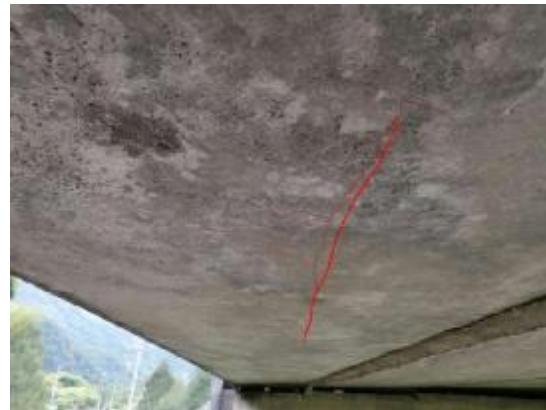
图 3-5: 菖上中桥(下行)1-12 空心板: 距 1 号墩 2m 处, 板底纵向裂缝; 数量: 1 条, 长度: 1.5m, 宽度: 0.1mm。
