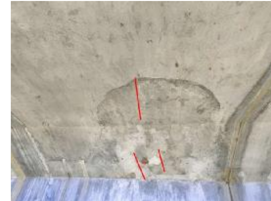
图 3-9: 翠溪 2 号特大桥(上行)6-6-8 箱梁: 右翼缘板横向裂缝; 数量: 3 条, 长度: 0.5m, 宽度: 0.12mm。
