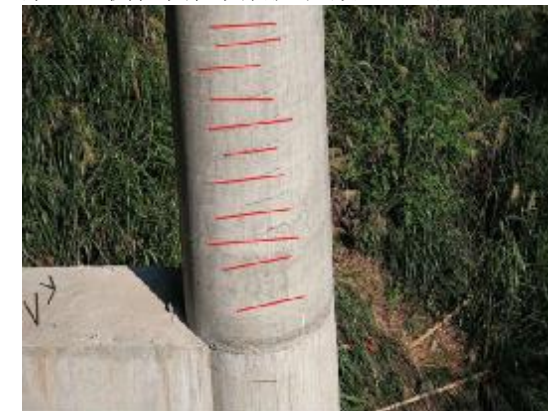
图 3-25: 新兴特大桥(上行) DS-7-1D 墩身: 墩身露筋; 数量: 11 处, 长度: 1m。
