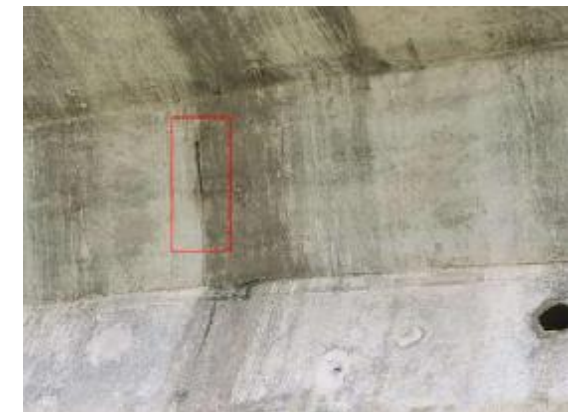
图 3-14: 大深坑 II 号大桥(上行)5YYB 箱梁: 距 5 号墩 20m 处, 右侧, 翼板与腹板交接处露筋; 数量: 1 处, 长度: 0.2m。
