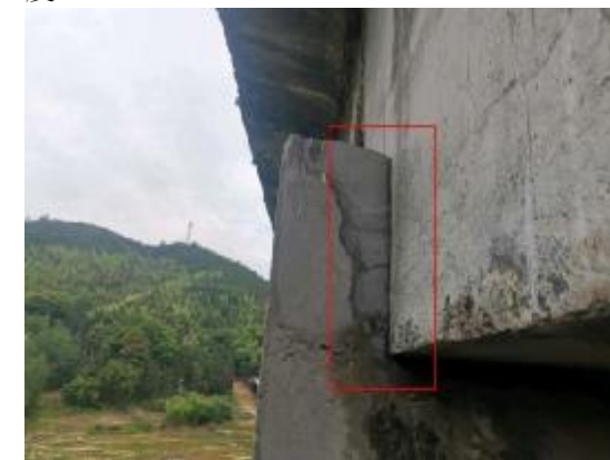
图 3-23: 塔前互通主线桥(下行) GL-8D 盖梁: 左侧挡块挡块抵死; 数量: 1 处。
