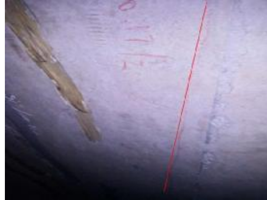
图 3-3: 大深坑 II 号大桥(上行)3D1NB 箱梁: 距 2 号墩 32m 处, 距右侧 1.8m 处, 梁顶纵向裂缝; 数量: 1 条, 长度: 2m, 宽度: 0.17mm。
