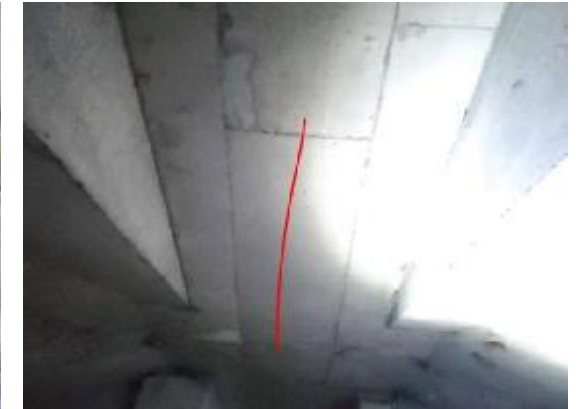
图 3-10: 翠溪 2 号特大桥(上行)8-7-17 箱梁: 距左侧 2.5m 处, 梁顶纵向裂缝; 数量: 1 条, 长度: 2.5m, 宽度: 0.13mm。
