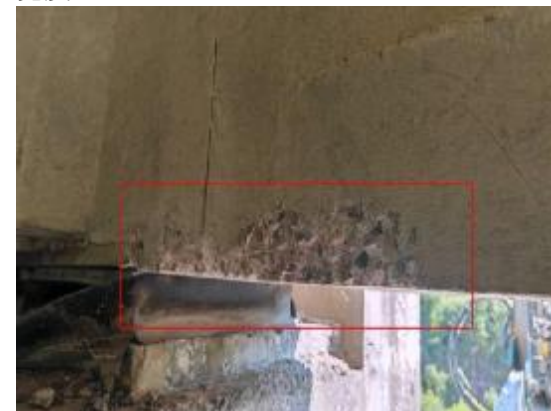
图 3-20: 新兴特大桥(上行) 15-1T 梁: 距 15 号墩 0m 处, 马蹄底面剥落; 数量: 1 处, 长度: 0.4m, 宽度: 0.05m。
