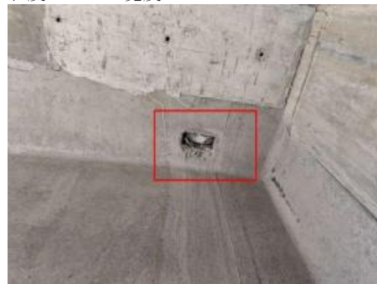
图 3-19: 新兴特大桥(上行) 10-1T 梁: 距 9 号墩 0m 处, 左翼缘板露筋; 数量: 1 处, 长度: 0.2m, 宽度: 0.1m。
