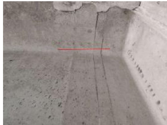
图 3-7: 新兴特大桥(上行)2-3T 梁: 距 1 号墩 0m 处, 左翼缘板纵向裂缝; 数量: 1 条, 长度: 0.5m, 宽度: 0.12mm。
