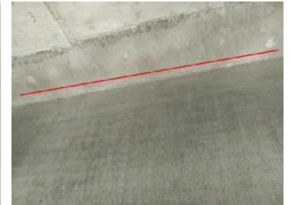
图 3-12: 岭根大桥(下行)4-2T 梁: 距 3 号墩 6m 起, 右翼缘板纵向裂缝; 数量: 1 条, 长度: 4m, 宽度: 0.12mm。
