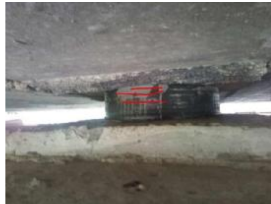
图 3-29: 十里亭 I 号大桥（下行）ZZ-8-8-2 支座：横向开裂；数量：1 条，长度：0.1m，宽度：1mm。
