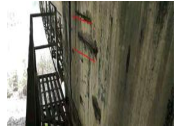
图 3-22: 大深坑 II 号大桥(上行) TS-7T 台身: 距左侧 1m 处, 前墙露筋; 数量: 2 处, 长度: 0.5m。
