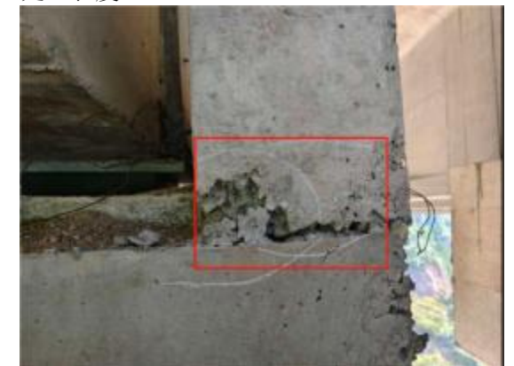
图 3-26: 翠溪 2 号特大桥(上行) GR-4D 盖梁: 距下缘 0m 处, 左侧挡块蜂窝、麻面, 露筋; 数量: 1 处, 长度: 0.4m, 宽度: 0.2m。
