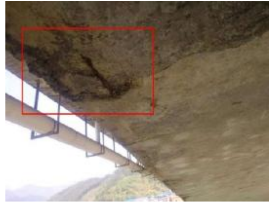
图 3-15: 西芹大桥(上行) 9D1B 箱梁: 距 8 号墩 19m 处, 距右侧 0m 处, 梁底破损露筋; 数量: 1 处, 长度: 0.2m, 宽度: 0.2m。
