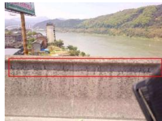
图 3-32: 西芹大桥（上行）HR-R-1 右侧护栏：距 12 号墩顶 5m 处，右侧露筋；数量：40 处，长度：0.1m。
