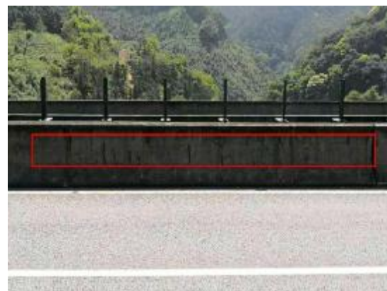
图 3-31: 大深坑 II 号大桥（上行）HL-L-1 左侧护栏：距 6 号墩顶 20m 处露筋；数量：10 处，长度：0.2m。
