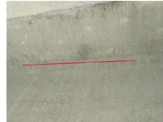
图 3-11: 上庄大桥(下行)3-4T 梁: 距 3 号墩 7m 处, 右侧, 翼板与腹板交接处纵向裂缝; 数量: 1 条, 长度: 2m, 宽度: 0.12mm。
