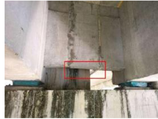
图 3-16: 西芹大桥(上行) 4-1-4H 横隔板: 底面露筋; 数量: 8 处, 长度: 0.1m。
