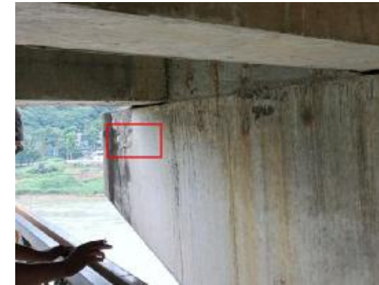
图 3-21: 西芹大桥(下行) GL-5D 盖梁: 距左侧 0m 处, 小桩号面露筋; 数量: 3 处, 长度: 0.1m。
