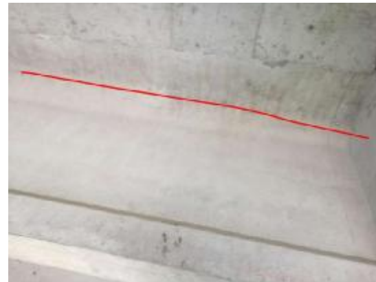
图 3-6: 塔前 2 号大桥(下行)4-2T 梁: 距 3 号墩 6m 起, 右翼缘板纵向裂缝; 数量: 1 条, 长度: 4m, 宽度: 0.12mm。
