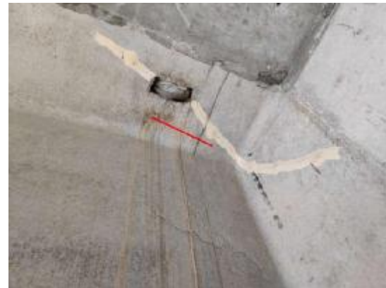
图 3-8: 新兴特大桥(上行)5-1T 梁: 距 4 号墩 0m 处, 左翼缘板纵向裂缝; 数量: 1 条, 长度: 0.7m, 宽度: 0.12mm。
