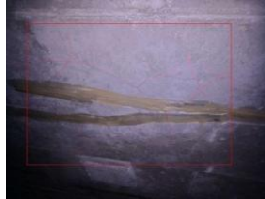
图 3-4: 大深坑 II 号大桥(上行)3D1NB 箱梁: 距 3 号墩 25m 处, 距右侧 2m 处, 梁顶网状裂缝; 数量: 1 条, 长度: 1m, 宽度: 0.18mm。
