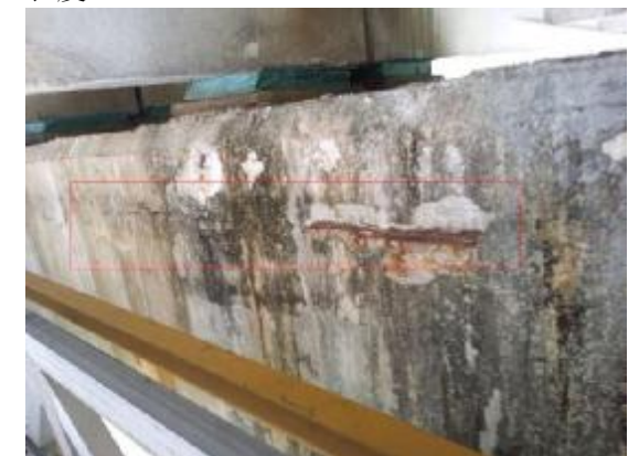
图 3-24: 塔前互通主线桥(上行) GR-4D 盖梁: 距右侧 5m 起, 大桩号面露筋; 数量: 1 处, 长度: 3m。
