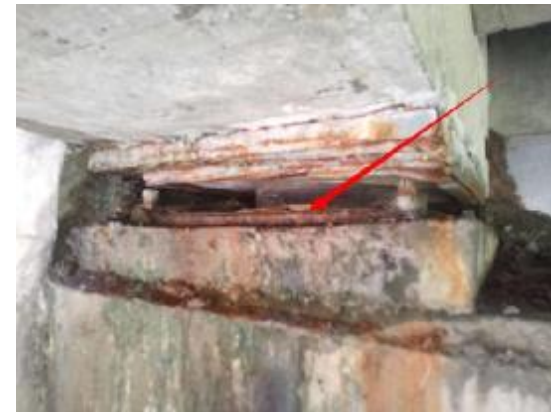
图 3-30: 十里亭 II 号大桥（上行）ZZ-15-15-5 支座：钢板锈蚀；数量：1 个。
