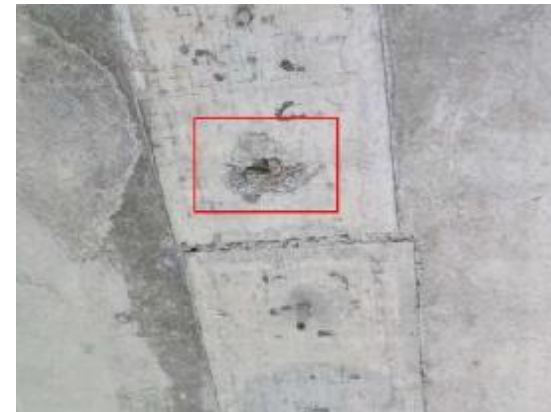
图 3-18: 龙泉大桥(上行) 4-3S 湿接缝: 距 3 号墩 12m 处剥落; 数量: 1 处, 长度: 0.15m, 宽度: 0.15m。
