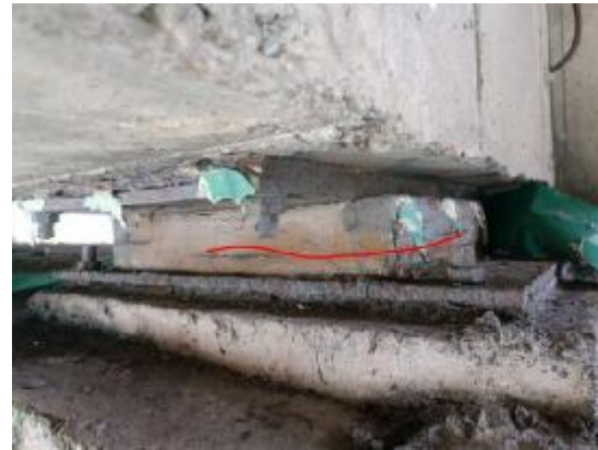
图 3-27: 西芹大桥（下行）ZZ-4-3-4 支座：横向开裂，大桩号侧；数量：1 条，长度：0.2m，宽度：1.5mm。
